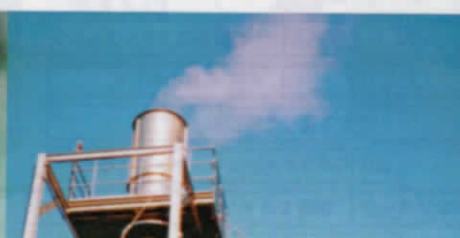
設備後の状況
